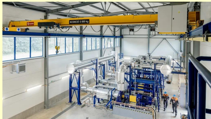
Čerpací stanice Obora v půlce trasy
